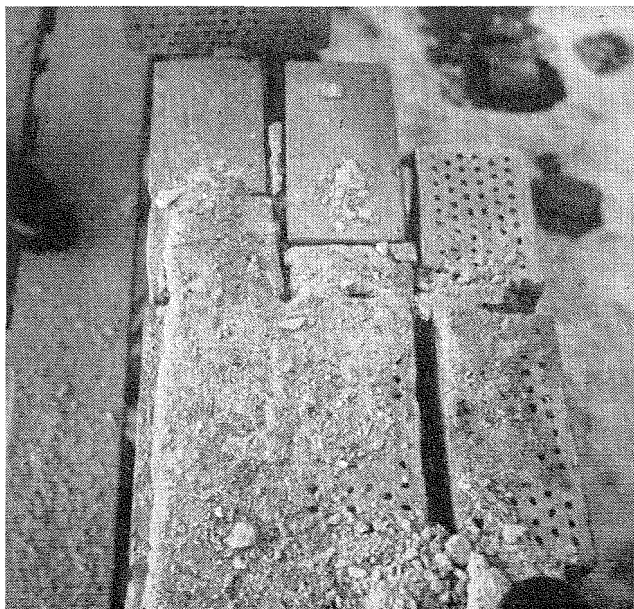
Fig. 6. Del af murflugt med fuger, hvis vidde er øget som følge af frostudvidelser. Fotograferet 3. 3. 1951.
